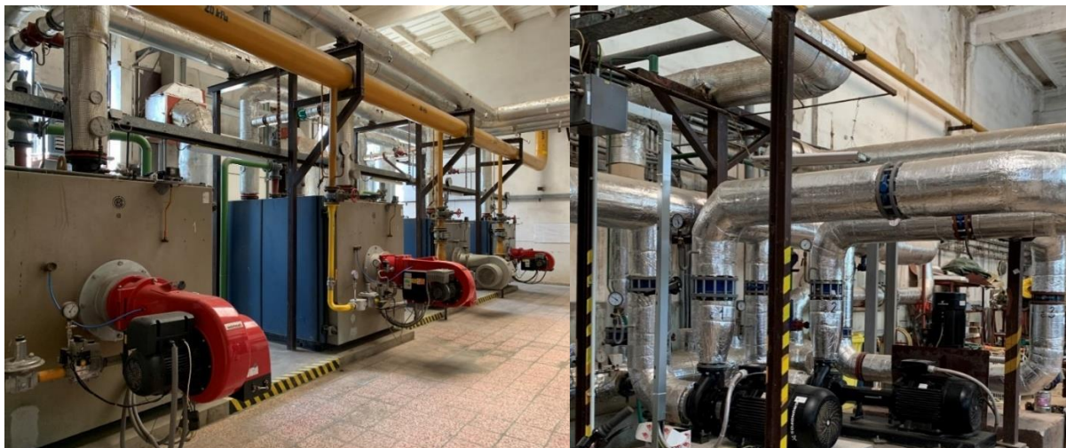
Obrázok 10: Technológia kotolňa K5 – kotly a obehové čerpadlá
