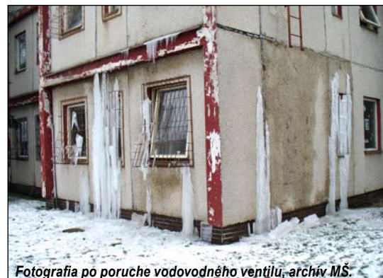
Fotografia po poruche vodovodného ventilu, archív MŠ.
