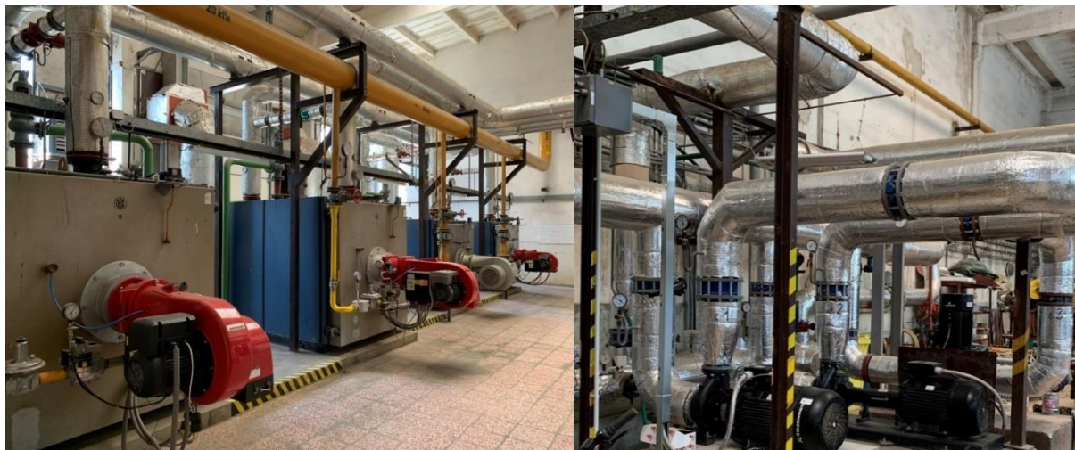
Obrázok 10: Technológia kotolňa K5 – kotly a obehové čerpadlá
